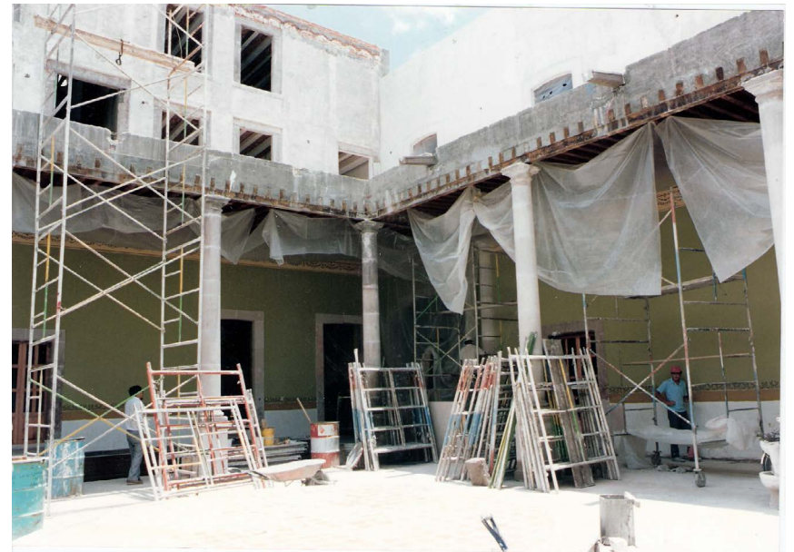
Obras de rescate, restauración y adaptación de los antiguos Baños de Los Arquitos, ca. 1993. AGICA, Fototeca.
